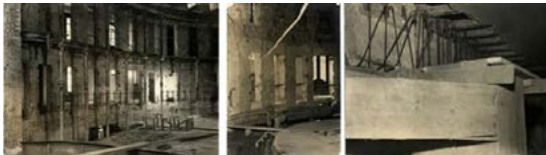
Figuras 13. Respectivamente, demolição dos setores originais da sala de espetáculos (esq.), construção de nova laje em concreto armado (centro) e armação da nova estrutura perimetral (dir.). Acervo de Fotografias do Arquivo Histórico Municipal de São Paulo.
